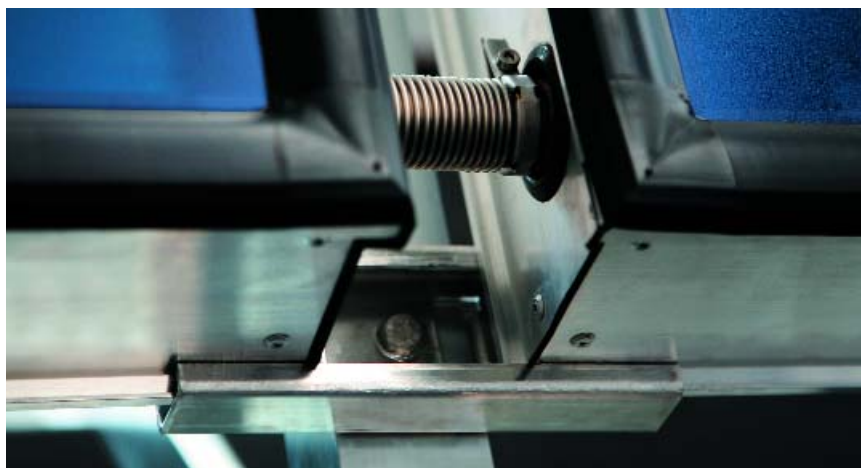
Raccordement avec des compensateurs
